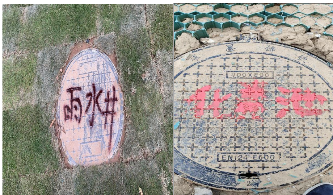
图4-1 小区雨水管网、化粪池
