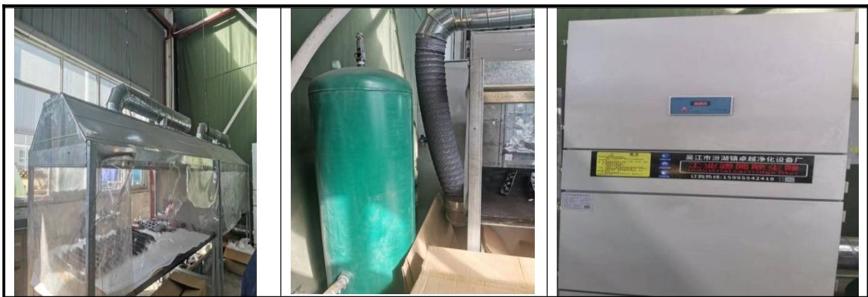
打磨平台侧后方设置集气罩+脉冲滤筒除尘器进行收集处理装置
