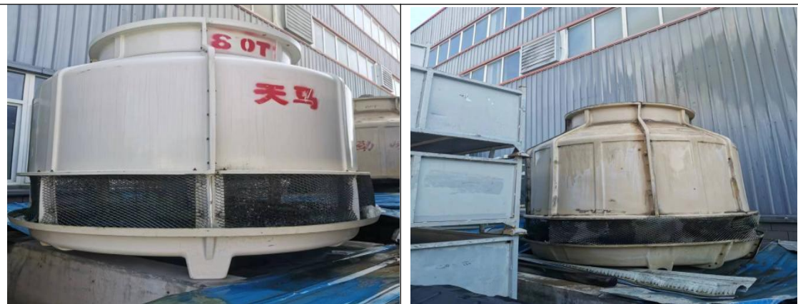
凉水塔、循环水池
